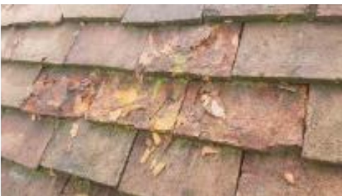
Dégradation des tuiles
