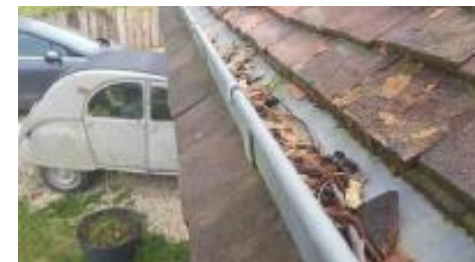
Absence de ventilation
