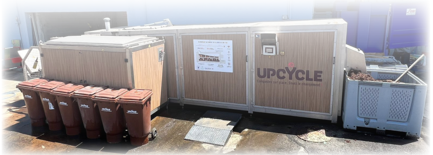
Groupe GBH, Carrefour Destreland, Baie-Mahault
